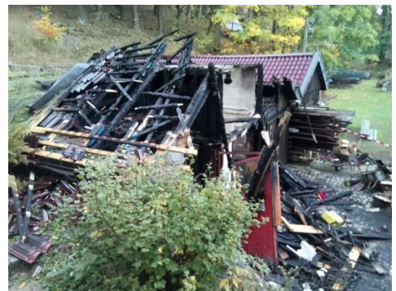
Ausgebrannter Dachstuhl kaue
